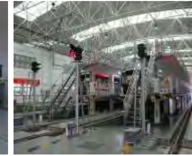
Inspection Center 检修中心
